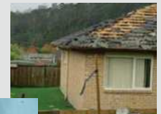
散乱した屋根瓦 (ニュージーランド)
